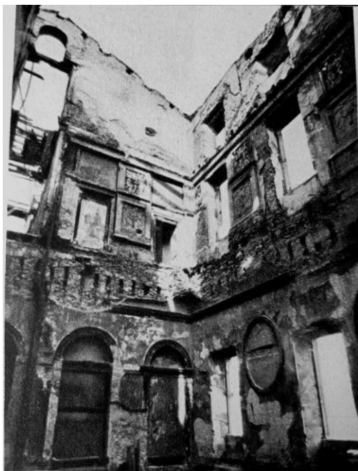
Fig. 49 Nella foto si nota il crollo totale dei soffitti dei vari piani (foto tratta da Palazzo Barbieri , Bergamo 1951).
